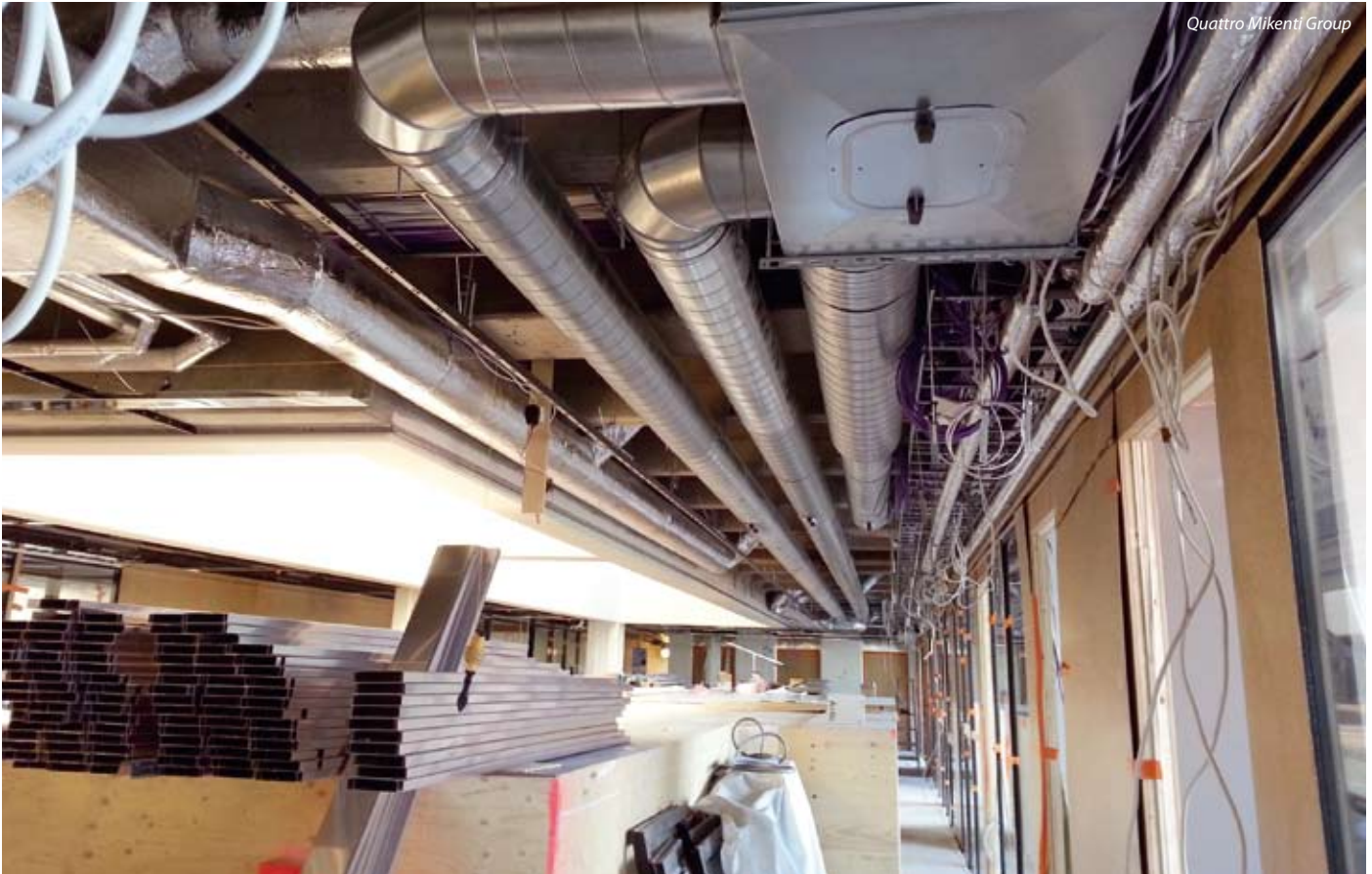
Kuntaliiton Kuntatalo Helsingin Alppilassa uusitaan peruskorjauksessa sekä tilojen että talotekniikan osalta nykyaikaiselle tasolle.
